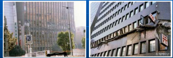
途中階部分の座屈
